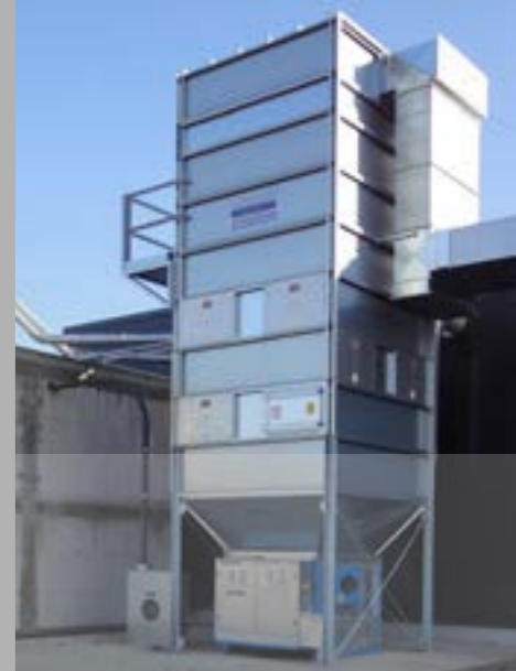
MultiStar Filter mit der BrikStar C Brikettierpresse in einer funktionellen Wettereinhausung und mit Silotransportleitung.
