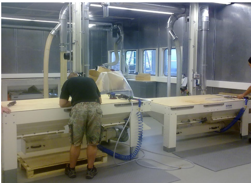
Zwei Expert Z 20 Schleifstaubabsaugtische in der Lackiervorbereitung
