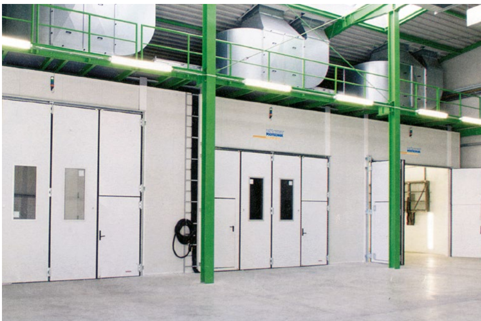
„Inteligentna” koncepcja trzech kabin umożliwia krótsze cykle technologiczne, obniża koszty zużycia energii oraz zapewnia pracownikom lakierni optymalne warunki pracy.
