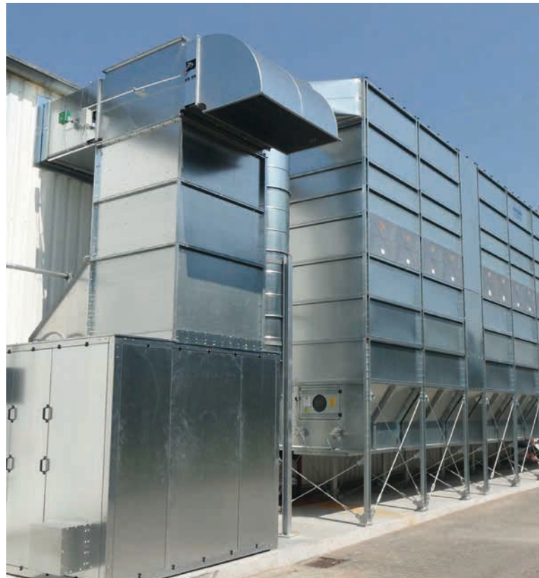
▲ Blick auf die Filteranlage im Unternehmen Pante
