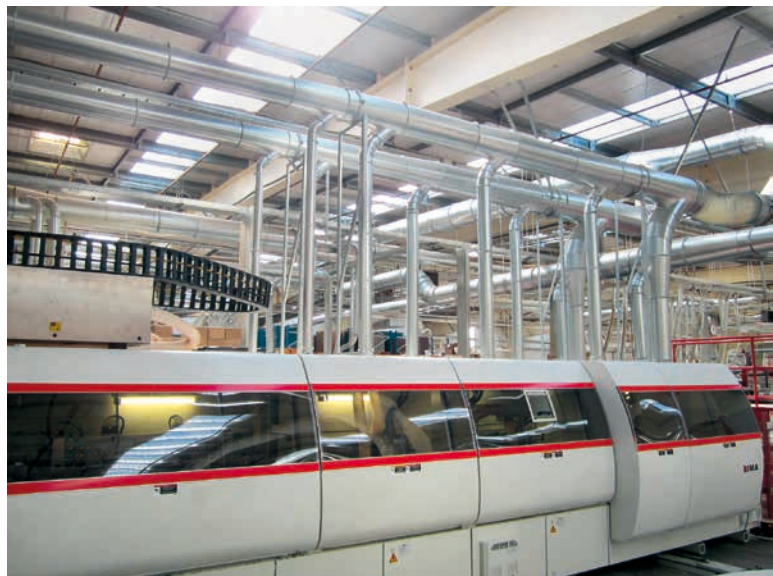
▼ Blick auf die Maschine mit Absaugrohren
