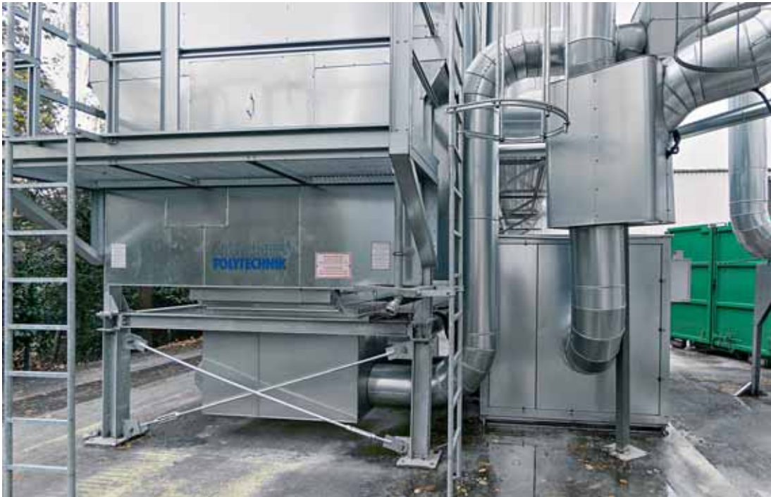
Die Zellenradschleuse (links) und der Transportventilator (rechts) wurden in Schallboxen gekapselt
