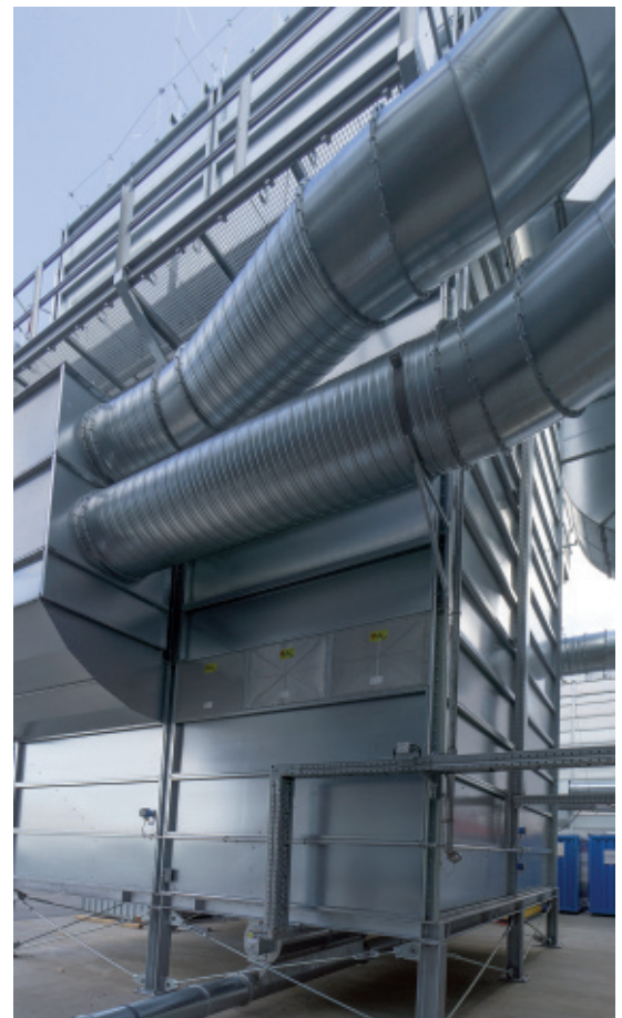
Austrag bei nobilia über Zellenradschleuse und pneumatischem Transport zum Silo.
