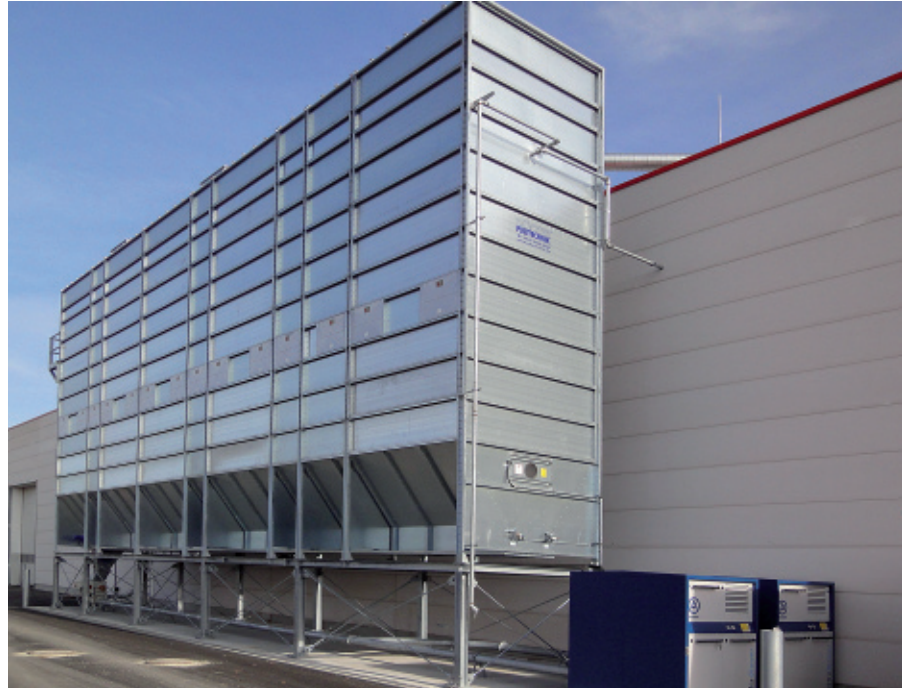
Der Küchenhersteller nutzt auch einen 15 Meter langen Spülluftfilter mit Austragung über Förderkette.
