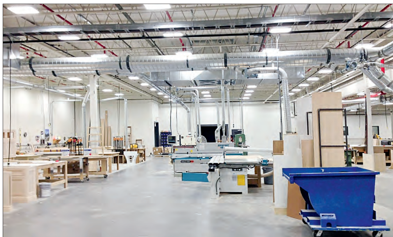
Der Umzug in neue Fertigungsräume wurde genutzt, auch die Absaug- und Filtertechnik zu erneuern
