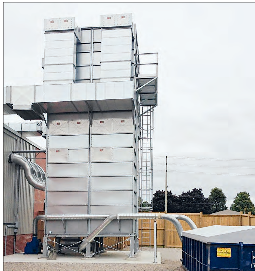
„Multi-Star“-Filteranlage mit einer Absaugleistung von 60 000 m 3 /h mit pneumatischem Austrag in Spänecontainer. Die auf einen Reststaubgehalt von etwa 0,1 mg/m 3 gereinigte Luft wird wieder in Produktionshalle geleitet, das senkt die Wärmeverluste und damit den Energiebedarf des Betriebes
