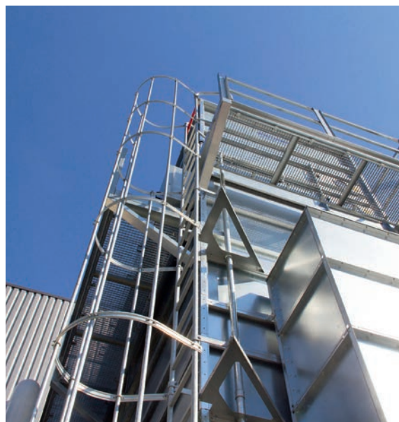
„Multi Star“-Filteranlage mit frequenzgeregelten, integrierten Ventilatoren.
