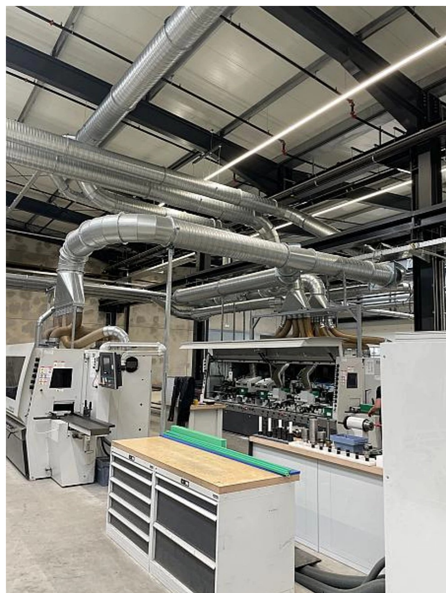
Maschinenabsaugung einer Hobelmaschine (mit Abzweigweiche). (Foto: Höcker)
