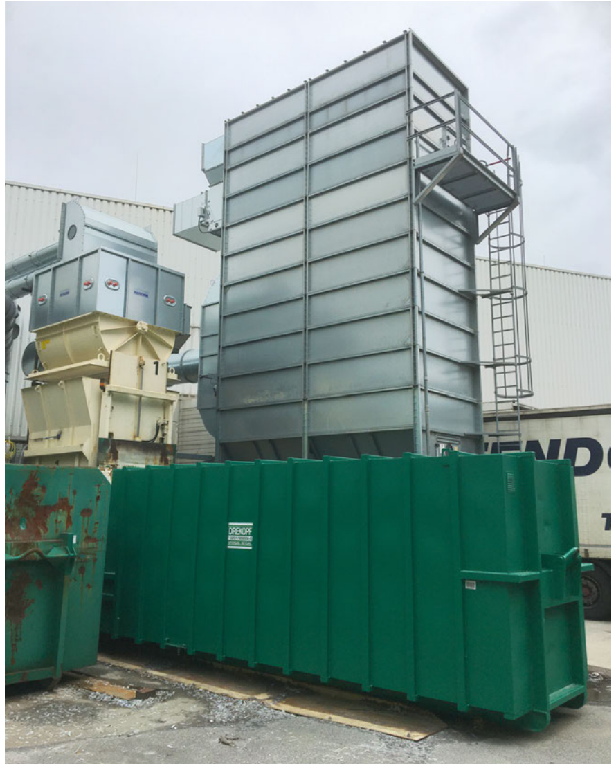
Filteranlage „MultiStar“ SL 10/5-309/34517A mit Materialabscheider PMA-U 160/19-3,0 V und stationärer Presse SHD2200. FOTOS: HÖCKER POLYTECHNIK
