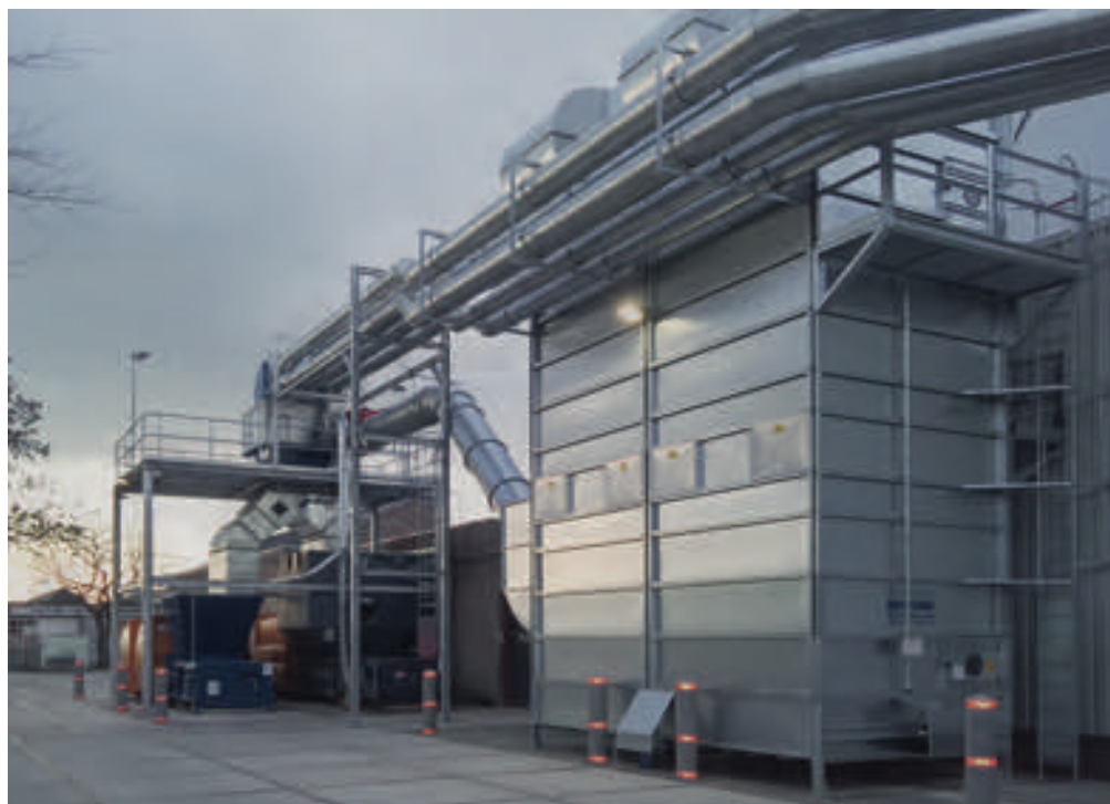
Energieeffiziente „Multi Star“-Filteranlage mit Schubboden.
