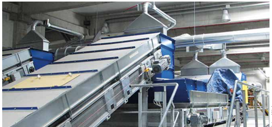
Die Absaugung erfolgt unter anderem direkt an der Bandanlage.
