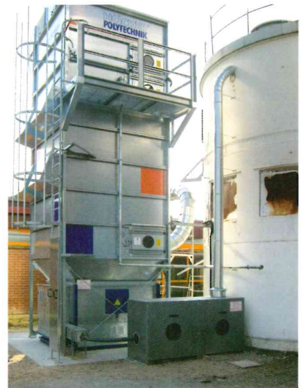
Die Filteranlage MultiStar VP mit BrikStar Brikettierpresse und Brikettleitung zum modifizierten Spänesilo.
