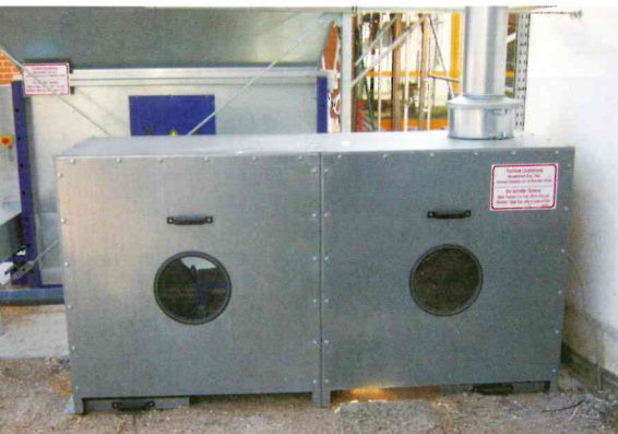
Brikettzuführung zum Brikettsilo mit Wetterschutzbehauung.
