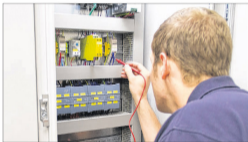
Marktführer bei Absauganlagen: Ein Elektrotechniker baut bei Höcker Polytechnik einen Schaltschrank. Foto: Höcker
